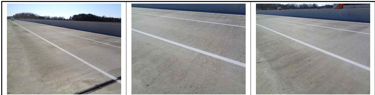
① 교면포장 망상균열 - 진전 여부확인
