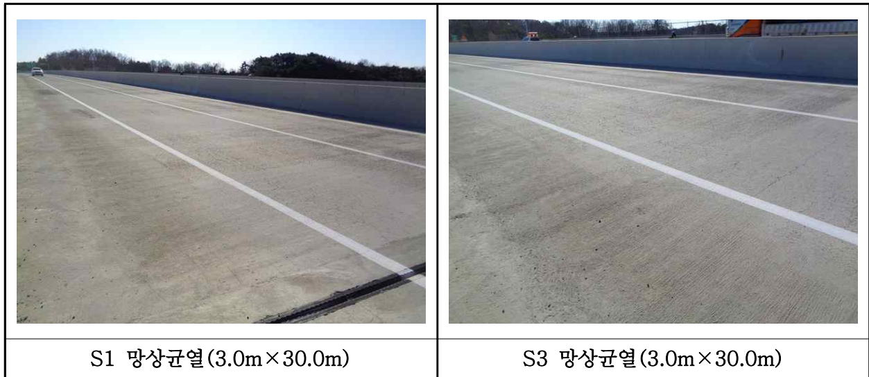
【사진 32.3.20】 교면포장 손상현황
