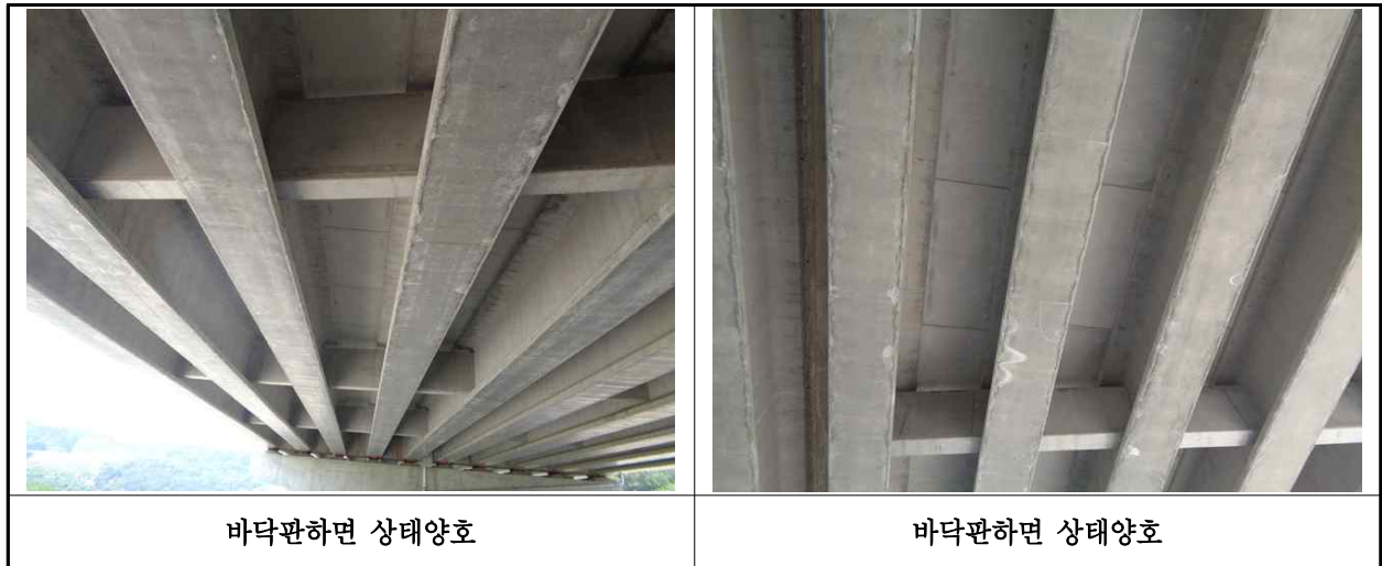
【사진 32.3.26】 바닥판하면 손상현황
