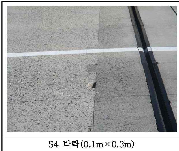
【사진 32.3.42】 교면포장 손상현황
