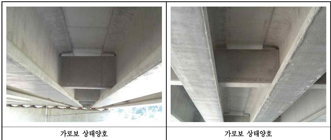
【사진 32.3.7】 가로보 손상현황
