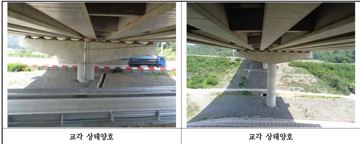
【사진 32.3.11】 교각 손상현황
