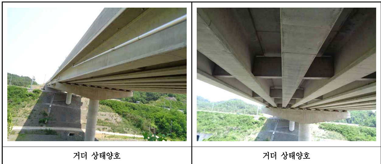
【사진 32.3.28】 거더 손상현황
